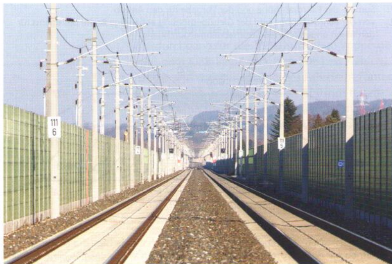
Bild 9: Oberleitungsbauart 2.1 auf dem zweigleisigen Streckenabschnitt St. Pölten – Linz.
