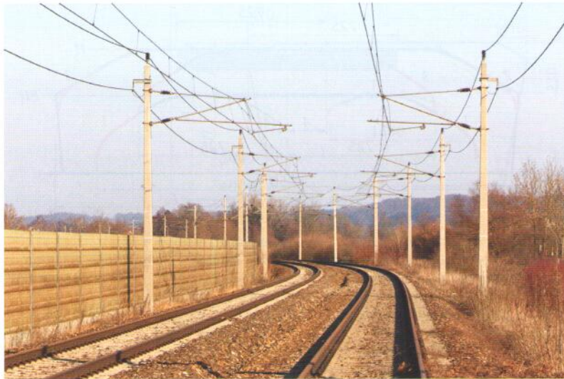
Bild 8: Oberleitungsbauart 1.3 auf dem zweigleisigen Streckenabschnitt Schärding 3 – Staatsgrenze.
