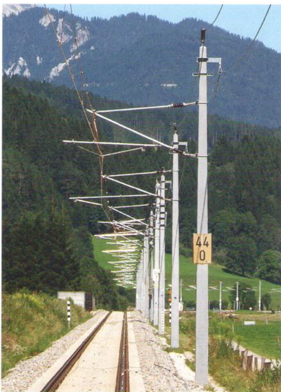
Bild 7: Oberleitungsbauart 1.2 auf dem eingleisigen Streckenabschnitt Schladming – Haus.
